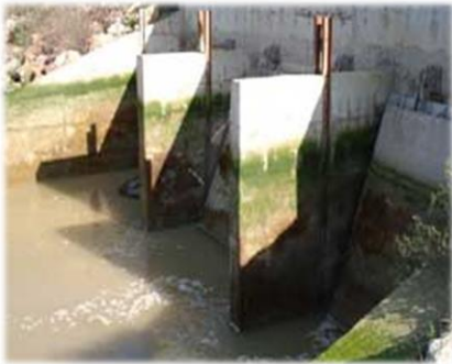
Clapetas en el desagüe del Caño de Trebujena.
