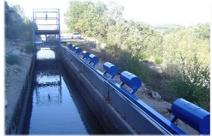
Clapetas de aliviadero con contrapeso regulable instaladas en el canal de aporte al embalse de Navamuño (Salamanca) C. H. Tajo.
