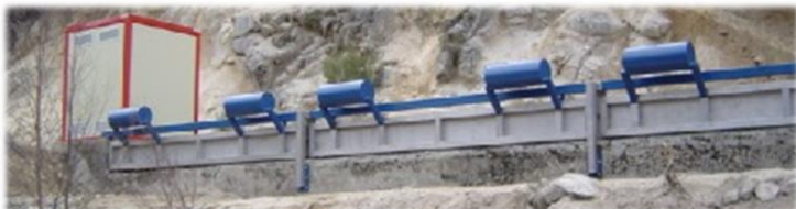
Clapetas de aliviadero con contrapeso regulable instaladas en el canal de aporte al embalse de Navamuño (Salamanca) C. H. Tajo.
