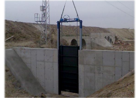
Compuertas instaladas en Valdeojos y Hornillo. Lebrija (Sevilla)
