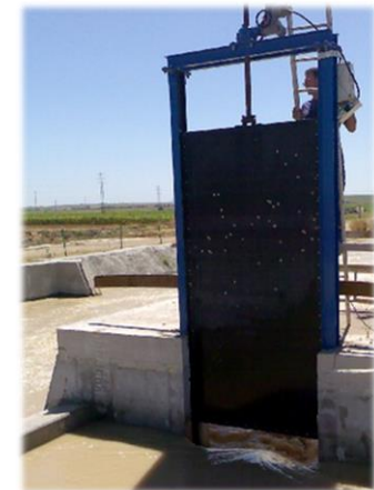
Compuerta para limpieza de aliviaderos en el Canal del Bajo Guadalquivir
