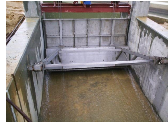
Compuertas Taintor Balsa de Aljaraque
