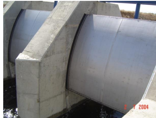
Compuertas Taintor Canal de Orellana
