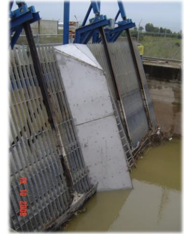
Limpiarrejas lineales en el canal del Bajo Guadalquivir. Confederaci3n Hidrogr'afica del Guadalquivir.
