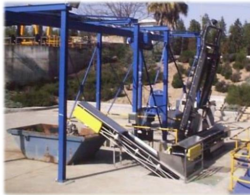
Limpiarrejas basculante en la EDAR San Jer3nimo. Emasesa
