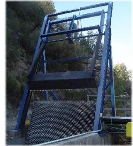
Limpiarrejas basculante en el canal de alimentación de la presa de Navamuño. Confederación Hidrográfica del Tajo.
